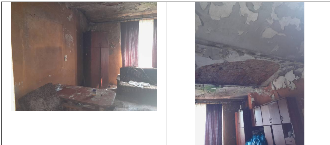
Budynek w ruinie, wykończenia zawilgocony, ubytki tynków, instalacje niesprawne
